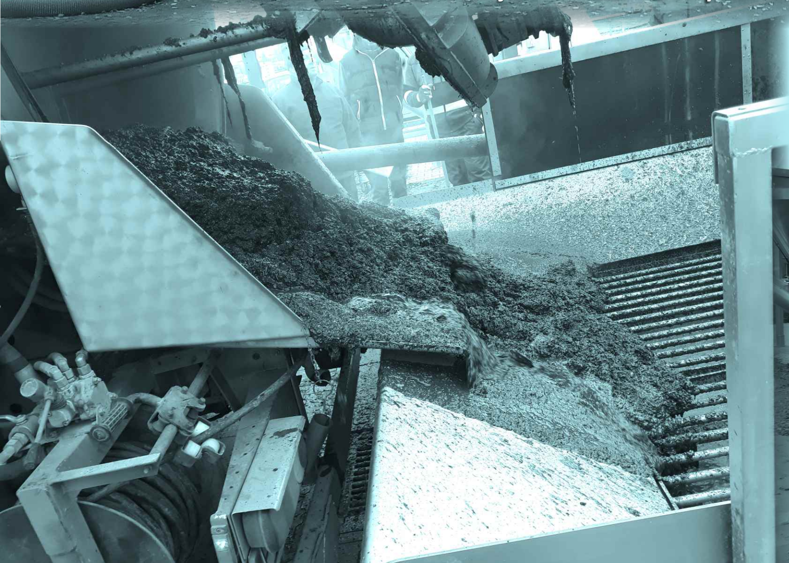
Instalacja do odbioru nieczystości
