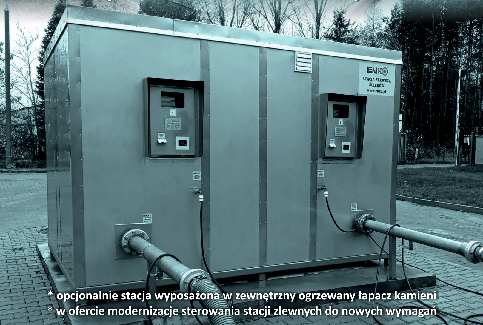
Stacja zlewna ścieków i osadów dowożonych STZ
